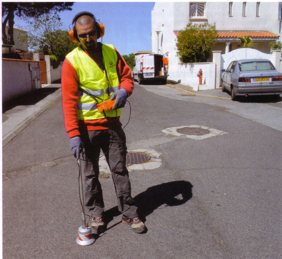
Des techniciens écoutent quotidiennement le réseau d'eau potable du territoire à la recherche de fuites.
