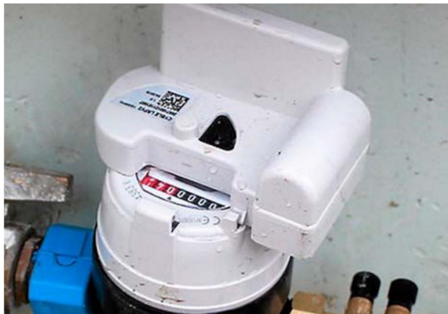
Les nouveaux compteurs communicants permettent un télérelevé en continu des consommations.
